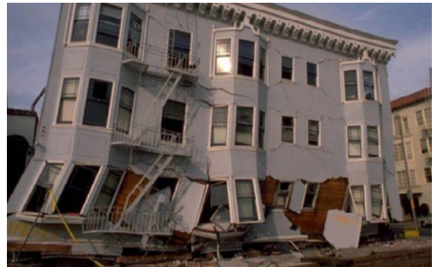
Şekil 8. Ahşap ve betonarme yapıların deprem sonrası durumları (Soldaki ahşap yapı, sağdaki betonarme yapı)
